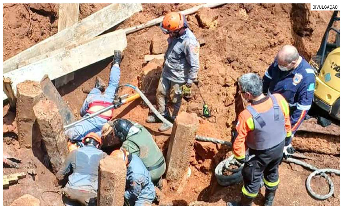
Vítima tentou escapar, porém ficou entre a terra e vigas de concreto que estavam no local
