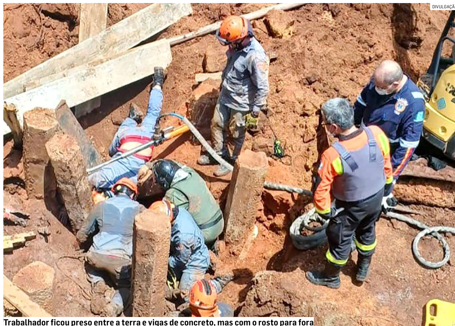
Trabalhador ficou preso entre a terra e vigas de concreto, mas com o rosto para fora
