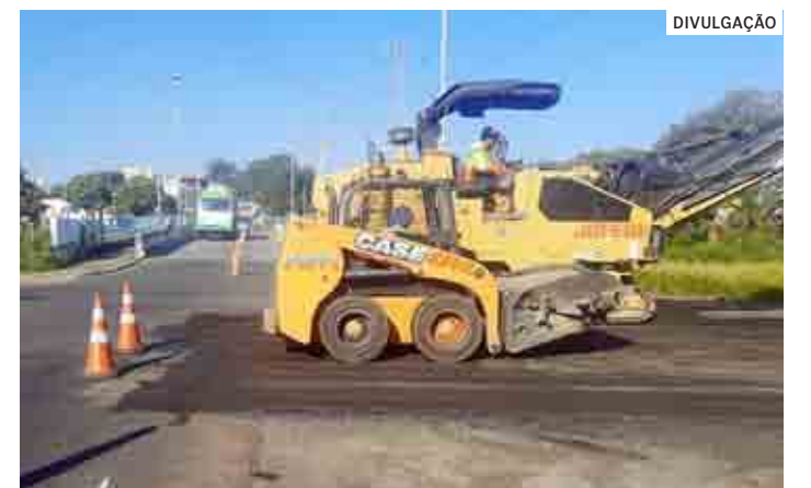
Funcionários da empresa contratada asfaltaram a pista da esquerda da Rua Flamboyant, no sentido bairro-centro
