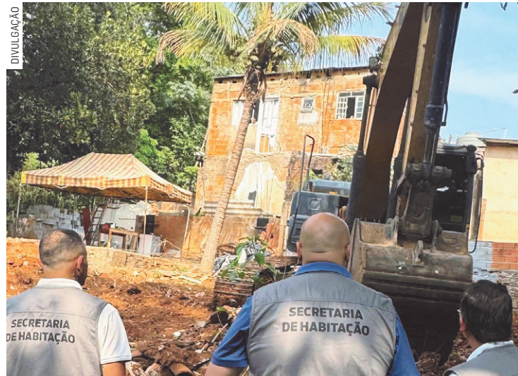
Ação começa abrir caminho para implantação da rede de esgoto nos bairros Jardim do Bosque e Jardim Santa Rita
