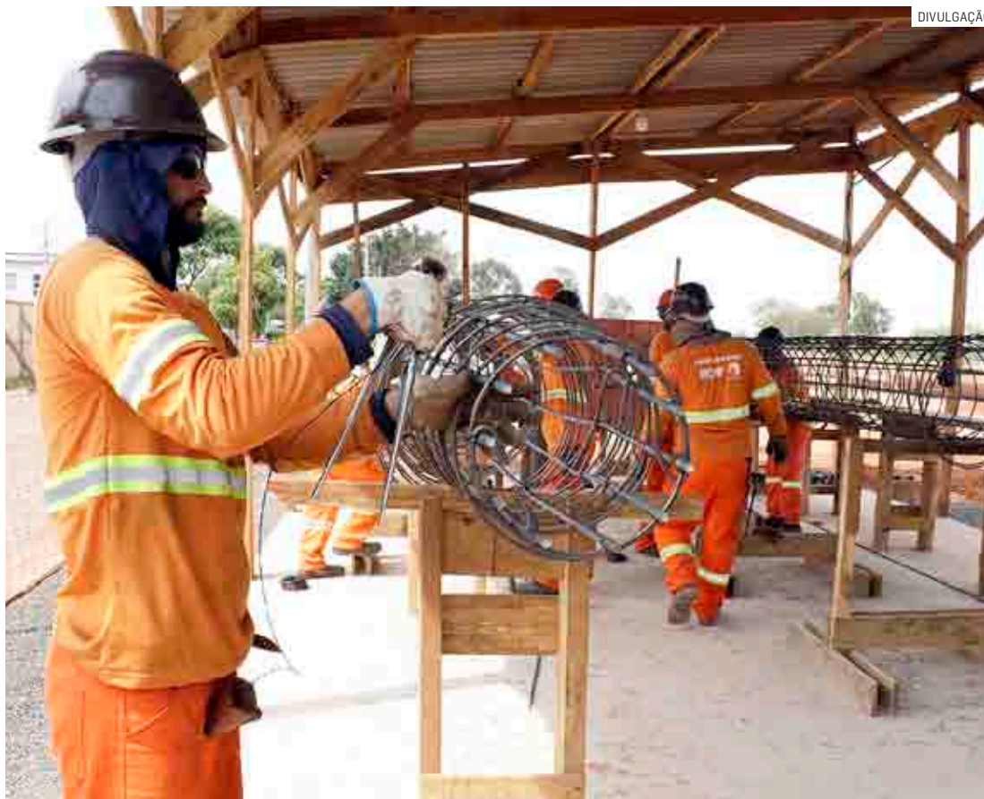
Zezé Gomes vistoriou o andamento da construção do viaduto, que terá 730 metros de extensão, garantindo acesso para a rodovia Anhanguera e D. Pedro I
