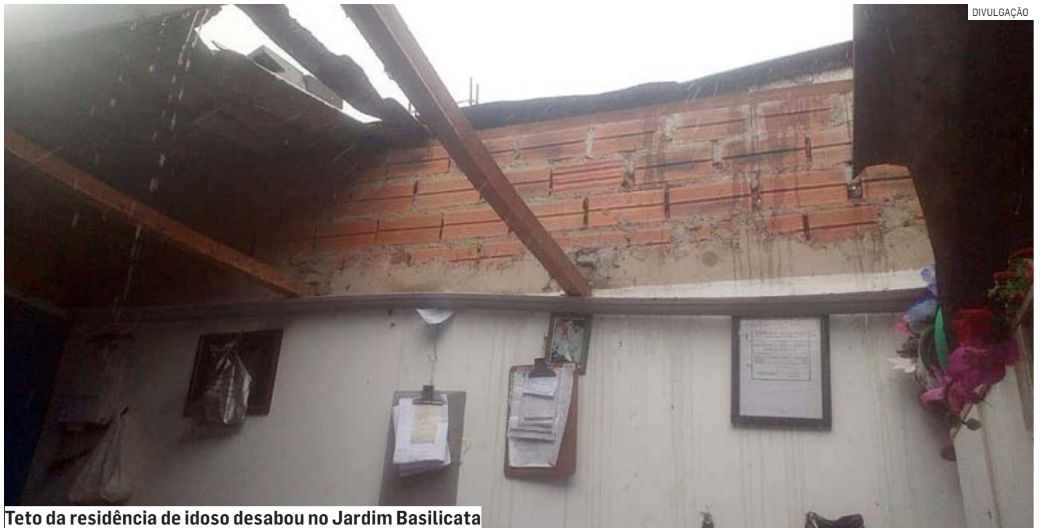
Teto da residência de idoso desabou no Jardim Basílicata
