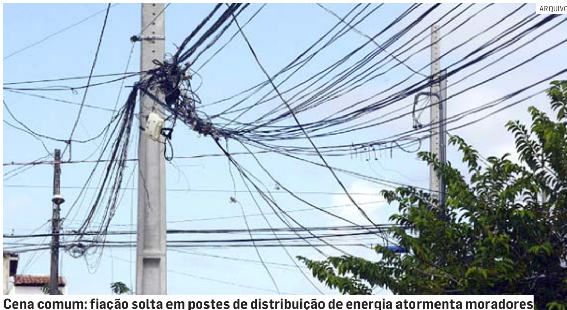
Cena comum: fiação solta em postes de distribuição de energia atormenta moradores
