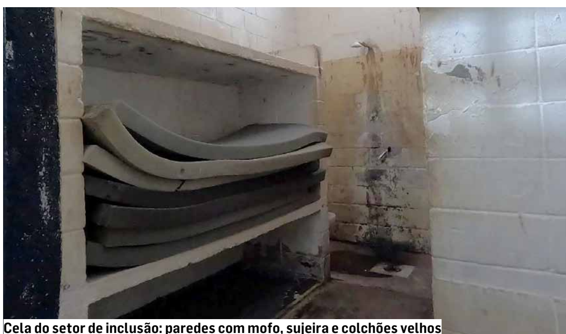
Cela do setor de inclusão: paredes com mofo, sujeira e colchões velhos
