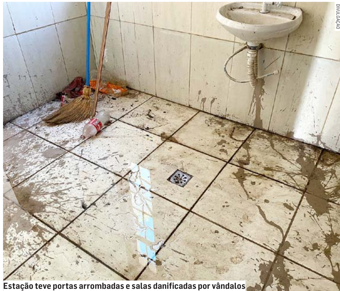
Estação teve portas arrombadas e salas danificadas por vândalos
