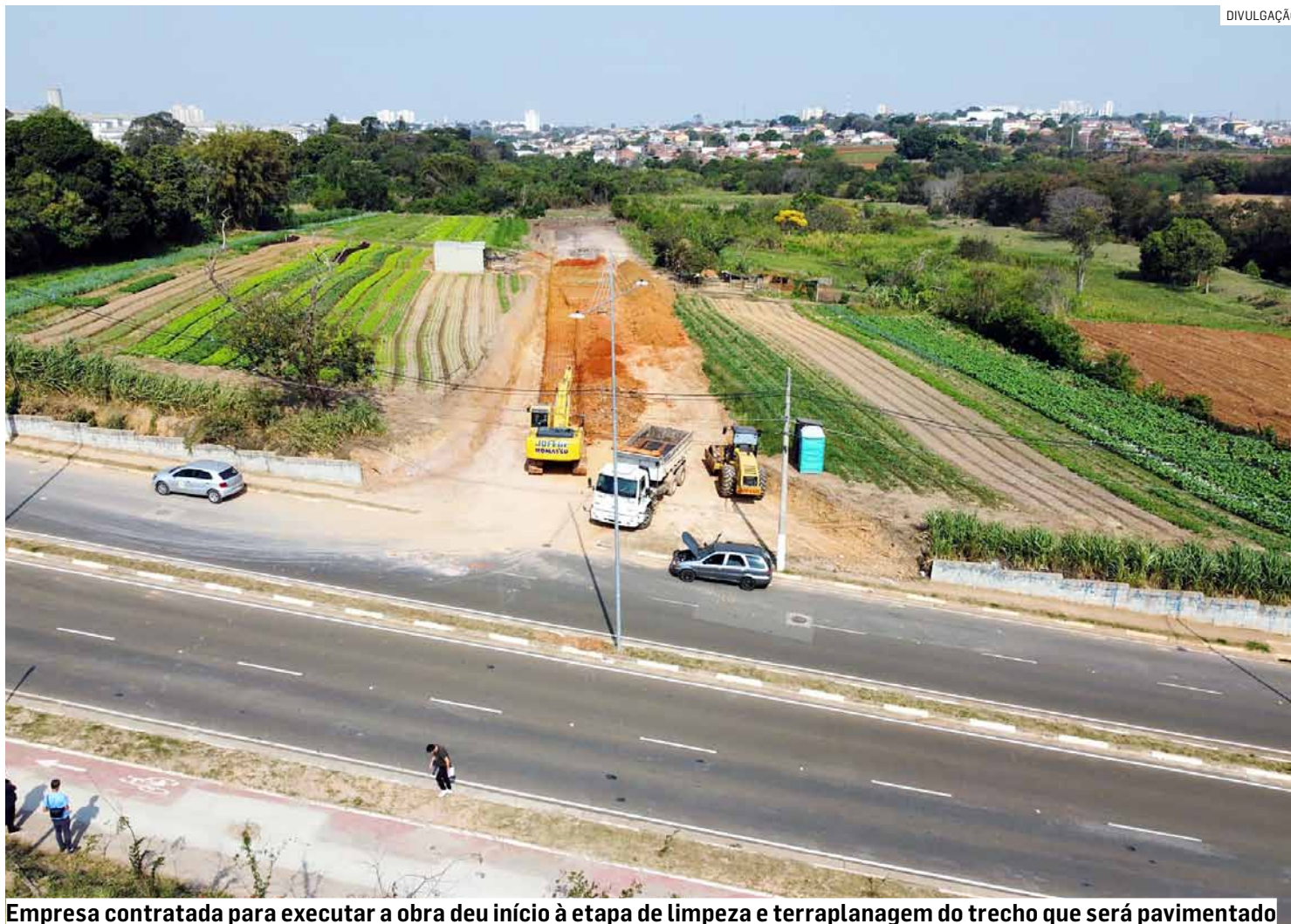
Empresa contratada para executar a obra deu início à etapa de limpeza e terraplanagem do trecho que será pavimentado
