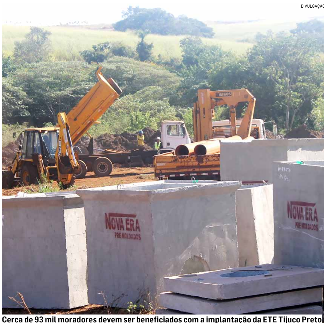
Cerca de 93 mil moradores devem ser beneficiados com a implantação da ETE Tijuco Preto
